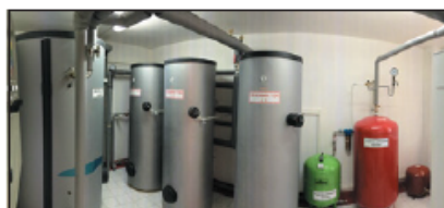
▲ Obr. ● Strojovna panelového domu v Turně nad Bodvou s tepelným čerpadlem země-voda NIBE F1345
