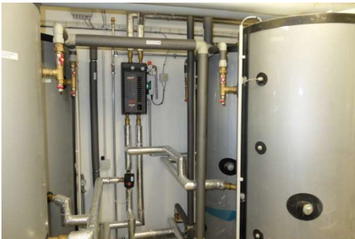
Рис. 2. Аккумулирующие резервуары в техническом помещении многоквартирного жилого дома – справа резервуары NADO 500/25 v6, слева резервуары NADO 750/35 v6, впереди группа насосов гелиосистемы Suntime (фотография PROPULS SOLAR s.r.o.)
