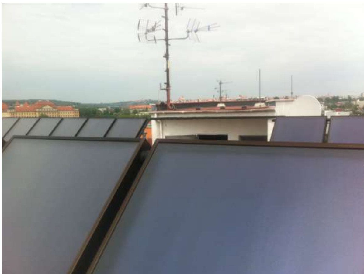
Рис. 1. Солнечные коллекторы на крыше многоквартирного жилого дома в Зноймо (фотография PROPULS SOLAR s.r.o.)
