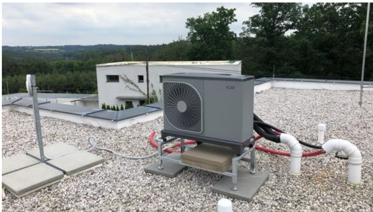
Venkovní jednotka tepelného čerpadla NIBE F2040-6 na střeše rodinného domu na Benešovsku
