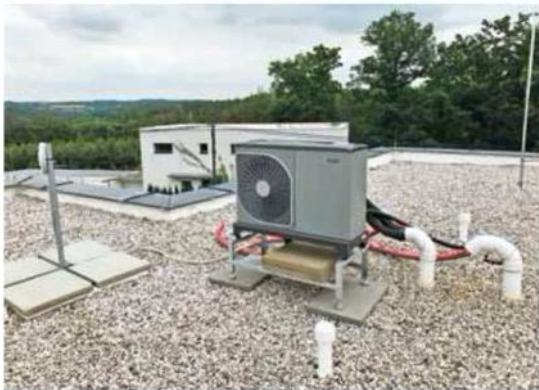
Venkovní jednotka tepelného čerpadla Nibe F2040-6 na střeše rodinného domu v Chářovicích. Systém vzduch-voda napojený na podlahové vytápění, řídicím modulem je chytrý regulátor SMO S40 z nové řady Nibe S, který automaticky reguluje vnitřní klima. Nibe.
