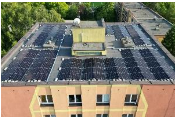
Fotovoltaická elektrárna na bytovém domě. Zdroj: Enado
